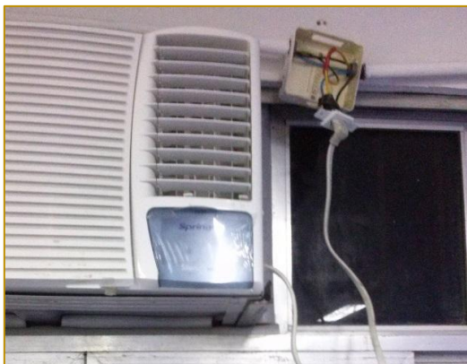
Figura 10 – Fotografia de ligação elétrica inadequada.
